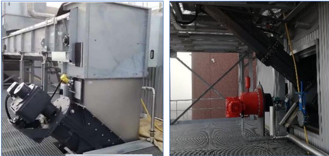
Figura 11 - VISTE FOTOGRAFICHE "ALIMENTAZIONE DIGESTORE TIPO"
