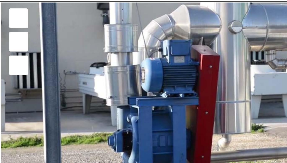
Figura 17 - VISTA FOTOGRAFICA DI UNA SOFFIANTE DEL SISTEMA DI "CLEANING BIOGAS"
