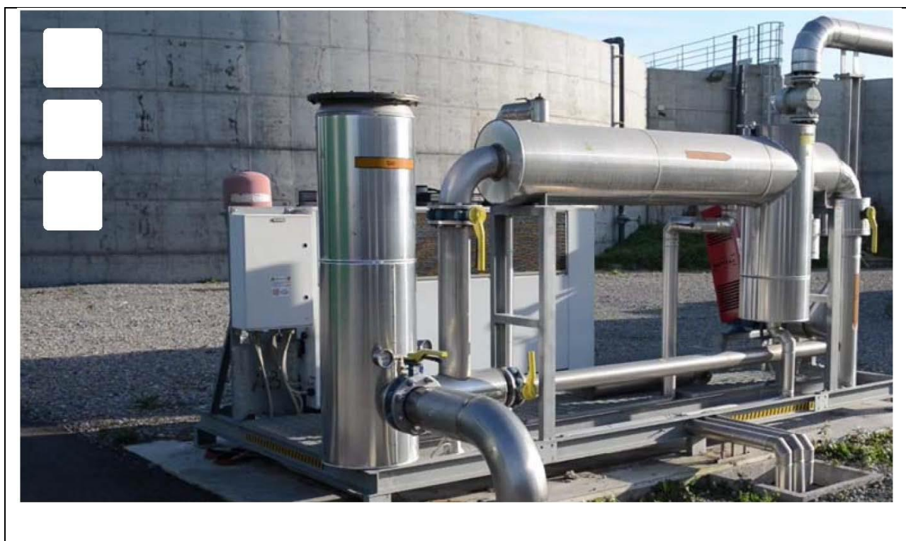
Figura 15 - VISTA FOTOGRAFICA DI UN SISTEMA DI "CLEANING BIOGAS"
