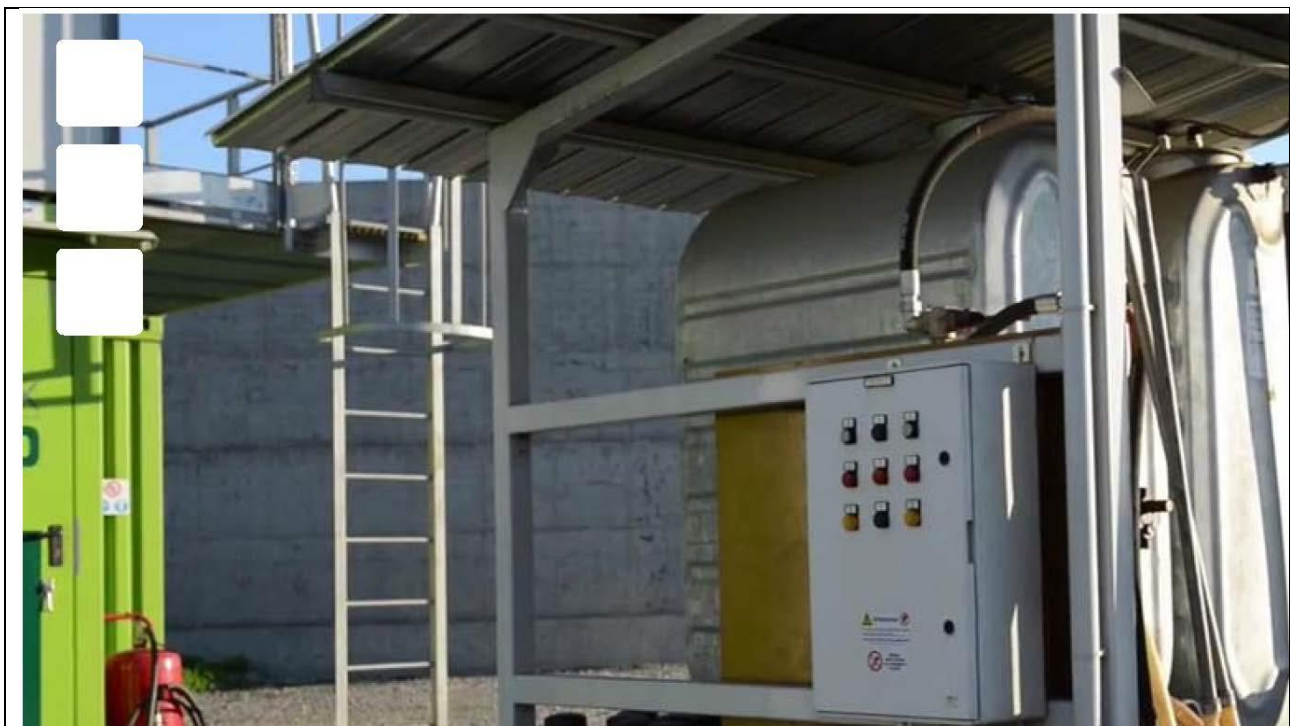
Figura 22 - VISTA DELLO "SKID OLIO TIPO"
