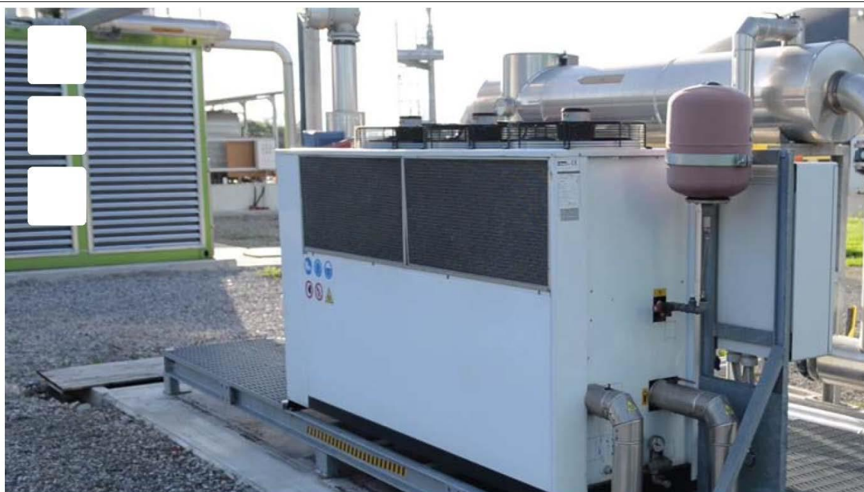
Figura 16 - VISTA FOTOGRAFICA DI UN CHILLER DEL SISTEMA DI "CLEANING BIOGAS"
