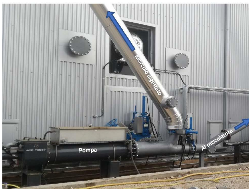
Figura 12 - VISTA FOTOGRAFICA DEL DISPOSITIVO DI "SCARICO TIPO" DEL BIODIGESTORE (POMPA)
